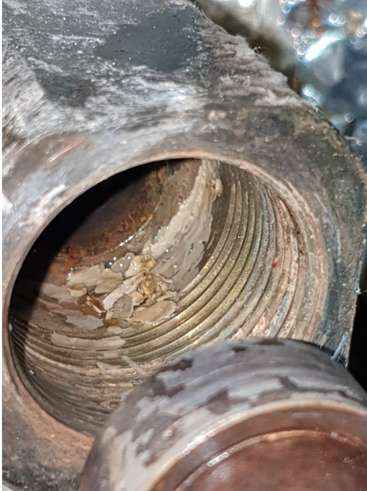
AFZETTINGEN OP KOPPELINGEN DOOR SCALING BIJ OPSTARTEN MET ZOUTHOUDEND BEDRIJFSWATER
