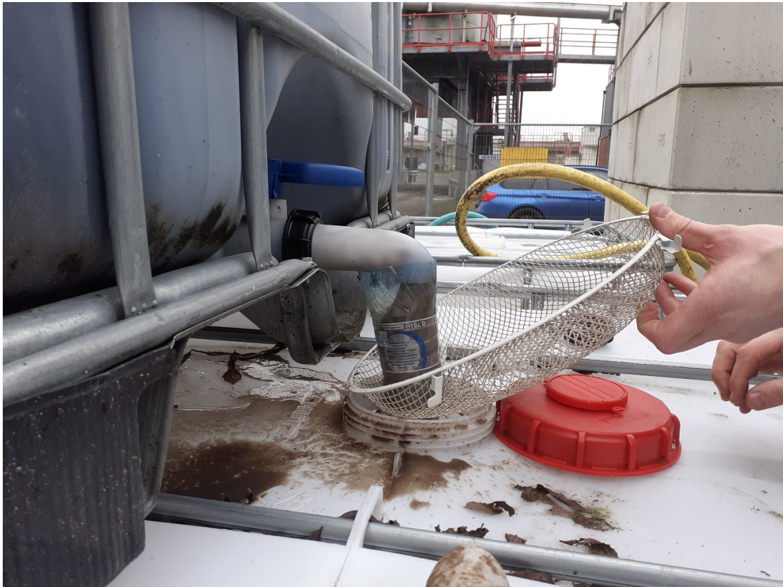
FIGUUR 8.1 GROVE FILTERING VAN SPUISSLIB VOOR INVOER IN DE INSTALLATIE
