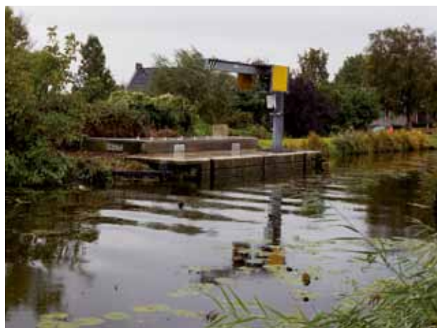
➔ Een kunstwerk uit de Koude Oorlog: schotbalkkering in de Berkelse Zweth op de grens van Delft en Rotterdam
